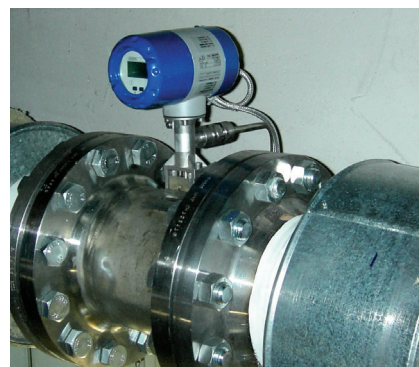
碳氢混合气管道
