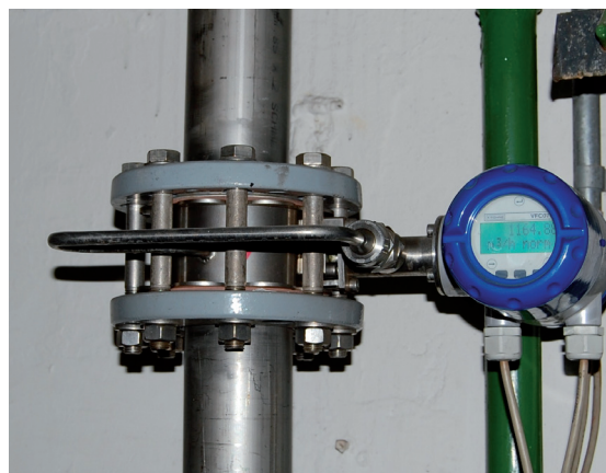
缩径的管道,便于流量测量
