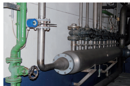
压缩空气的分输设备
