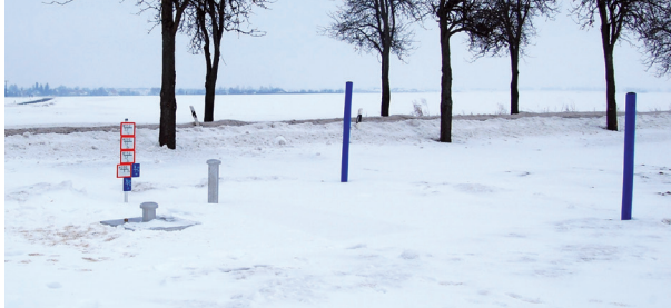
一口非常偏远的分输井, 无法使用需要外部供电的测量仪表
