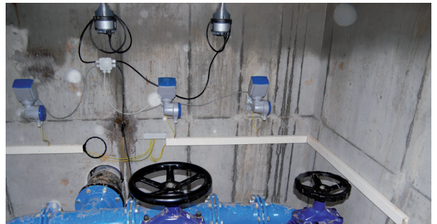
3 台 WATERFLUX 070 F 转换器和 2 台 KGA 42
