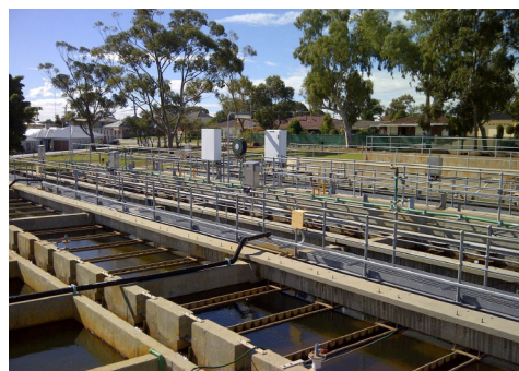
污泥泥位计安装在沉淀池上
