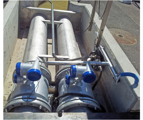
安装在污水明渠上的 TIDALFLUX 2300
