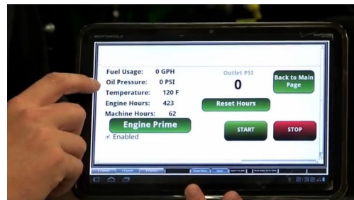
为泵控制系统进行显示
