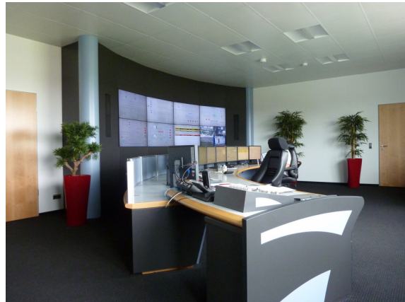
控制室内的测漏检测系统
